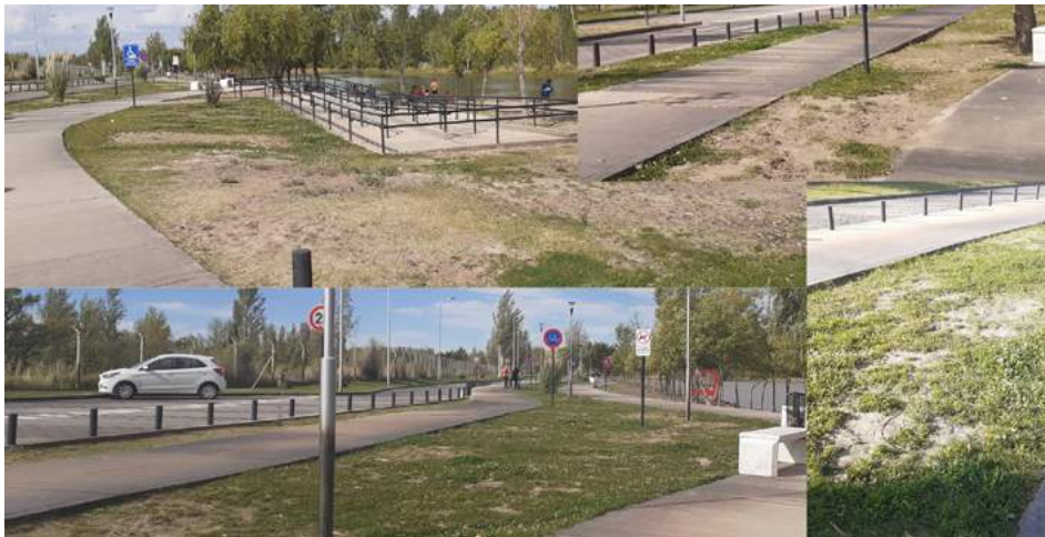
Figura 10 Erosión. Balneario Sandra Canale
