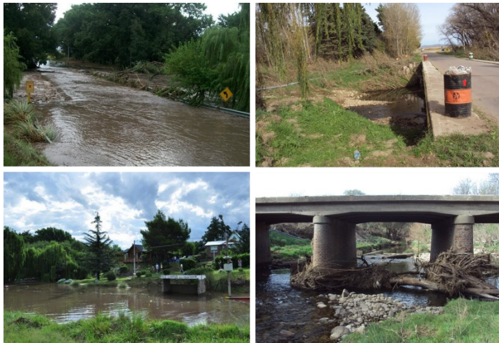
Figura 5. Crecida del año 2011 y sus consecuencias sobre el puente de acceso. Fuente: Fotografías de las autoras.
