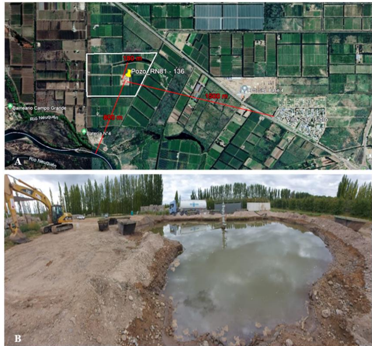
Figura 3. A: Mapa de zona correspondiente al derrame de petróleo en Campo Grande. B. Avance del tamaño de excavación con hidrocarburo debido a incidente. Fuente: propietaria del establecimiento.
